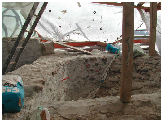
Renforcement de la maçonnerie et des voûtes par injection de la maçonnerie après l'incendie. Renforcement d'un arc en pierre par l'adjonction d'un tirant foré dans la maçonnerie (forage de 11 [m]).
